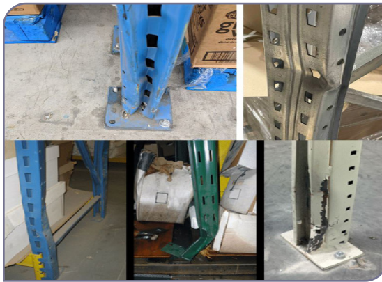
شکل ۴-۶. برخی از عیوب پایه‌های قفسه‌ها
